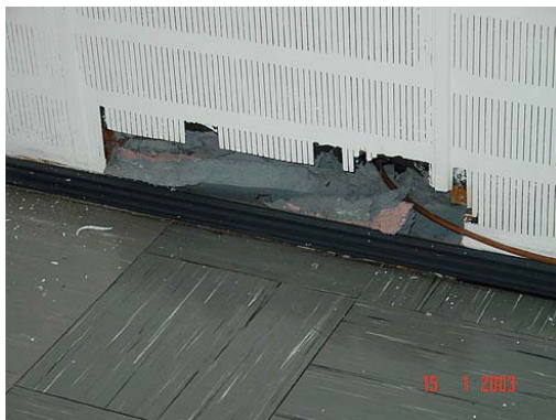
Mauerdurchbruch mit asbesthaltiger Litaflexspritzmasse
