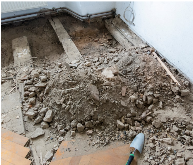
Abb. 1: Fehlbodenschüttung aus Bauschutt und Schlacke
