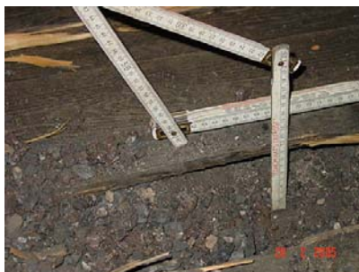
Fehlbodenfüllung mit PAK-haltiger Schlacke
