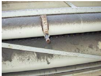
Rohrummantelung mit Asbestgewebe
