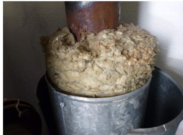
Abb. 2: Rohrisolierung aus KMF (gelb) mit Metallummantelung (grau)
