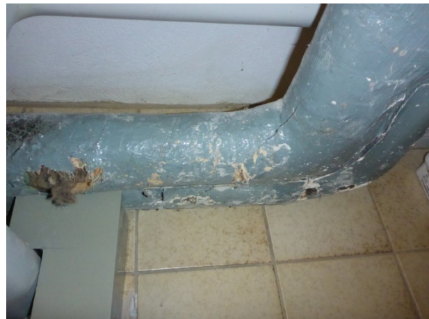
Abb. 4: Rohrisolierung aus KMF mit asbesthaltiger Ummantelung
