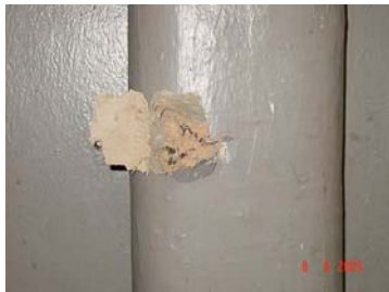
Rohrisolierung mit asbesthaltiger Brandschutzmasse
