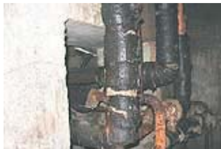
mit Teerpappe (stark PAK-haltig) ummantelte Fernwärmeleitungen
