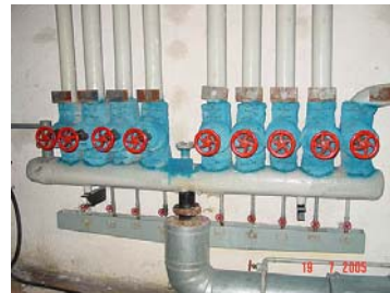
Schieberummantelung aus Asbestgewebe
