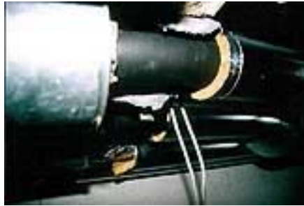
asbesthaltige Rohrisolierung (bläulich)
