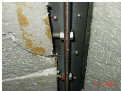
Asbestschnur im RLT - Kanalflansch
