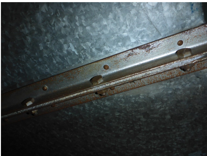
Abb. 1: Asbestschnur im RLT-Kanalflansch
