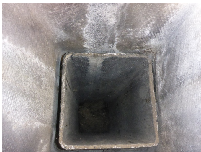
Abb. 2: Lüftungskanal aus Asbestzement
