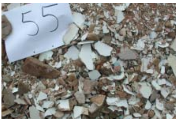
abgetrennter Putz mit Farbanstrich
