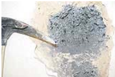
Schlackehaltiger Porenbeton hinter Wandputz und Farbe
