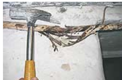
Kabelisolierung einer Elektro-Hausanschlussleitung aus Teer-Faser-Gemisch
