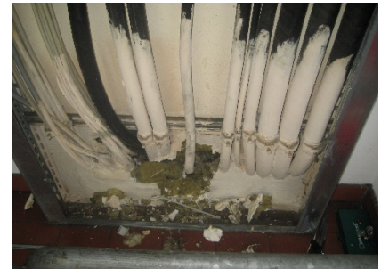
Abb. 3: Kabelschott mit Asbest und KMF
