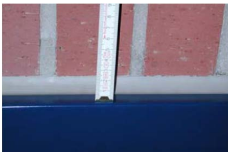
Abb. 1: Verklinkerte Betonwand mit PCB -haltiger Dehnungsfuge
