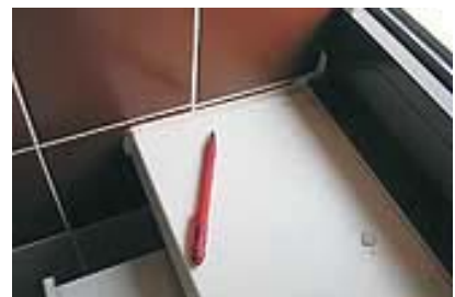
Fugenmasse im Sanitärbereich (Stiftspitze) mit Verdacht auf PCB
