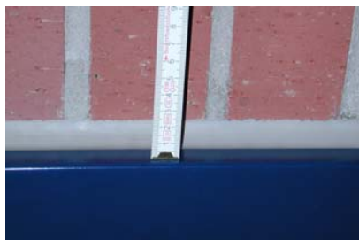
Verklinkerte Betonwand mit PCB-haltiger Dehnungsfuge
