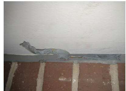
Abb. 3: PCB -haltige Fugendichtmasse
