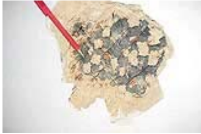
stark PAK-haltige Teerpappe (schwarz) unter Mineralputz mit Putzträger
