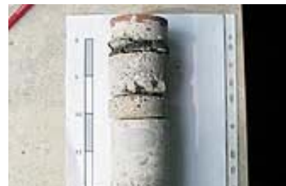
Bohrkern einer Geschosdecke mit (von oben nach unten): Fliese, Estrich und PAK-haltiger Isolierschicht (schwarz)
