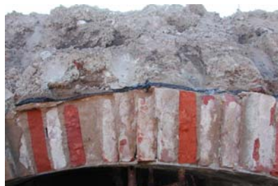
Gewölbe mit aufgeklebter Sperrbahn
