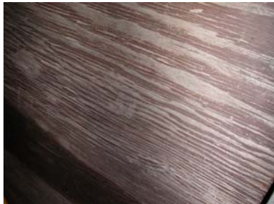
Holz im Außenbereich mit abgewitterter Holzschutzfarbe
