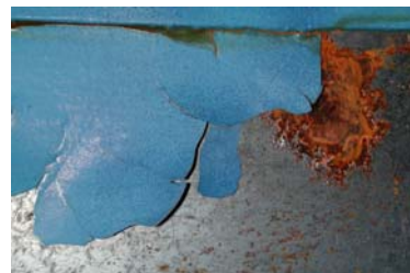
Lackfarbe mit PCB-Verdacht auf Metalloberfläche
