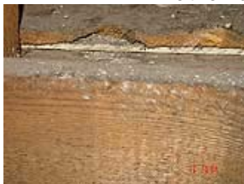
asbesthaltige Platte über Heizkörper
