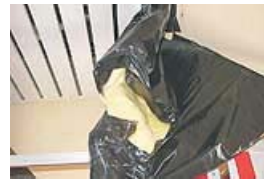
KMF in Kunststoffolie in einer Deckenverkleidung
