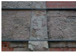
künstliche Mineralfasern KMF hinter Fassadenverkleidung
