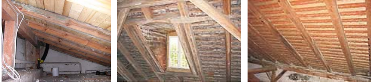
Dachstuhlholz mit Verdacht auf Holzschutzmittel
