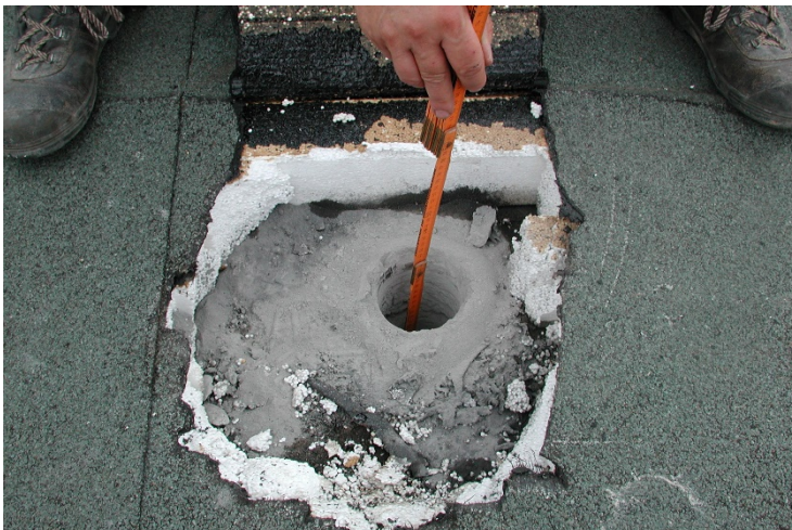
Abb. 1: Polystyrol-Dachdämmung unter teer- und asbesthaltiger Dachpappe
