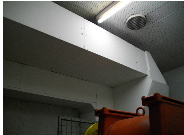
Abb. 2: Brandschutzverkleidung mit asbesthaltigen Platten
