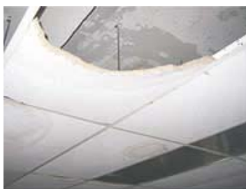
Dämmplatte aus KMF mit PCB-haltiger Farbbeschichtung
