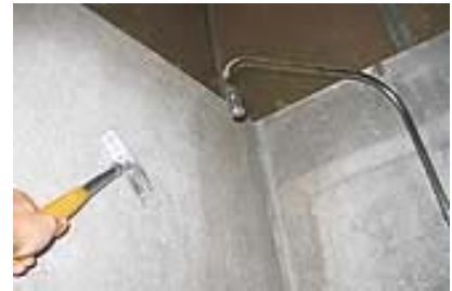
Asbestzementplatte als Abtrennung einer Duschkabine
