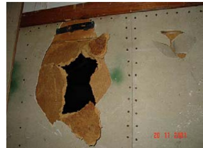
Wandverkleidung aus asbesthaltigen Leichtbauplatten
