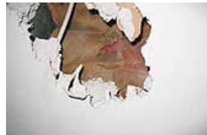
Detailaufnahme einer KMF-haltigen Gipskartonplatte
