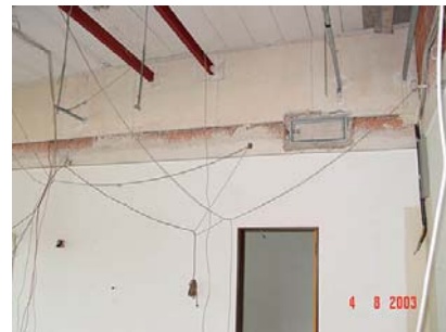
Promabestplatten hinter abgehängter Decke, Brandverkleidung
