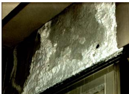
Sokalitplatte mit Ausblühungen
