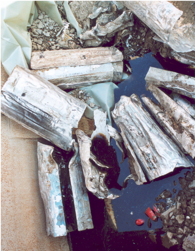
Bild 9 Deponie Kalbach - Durchberstete Manschetten
