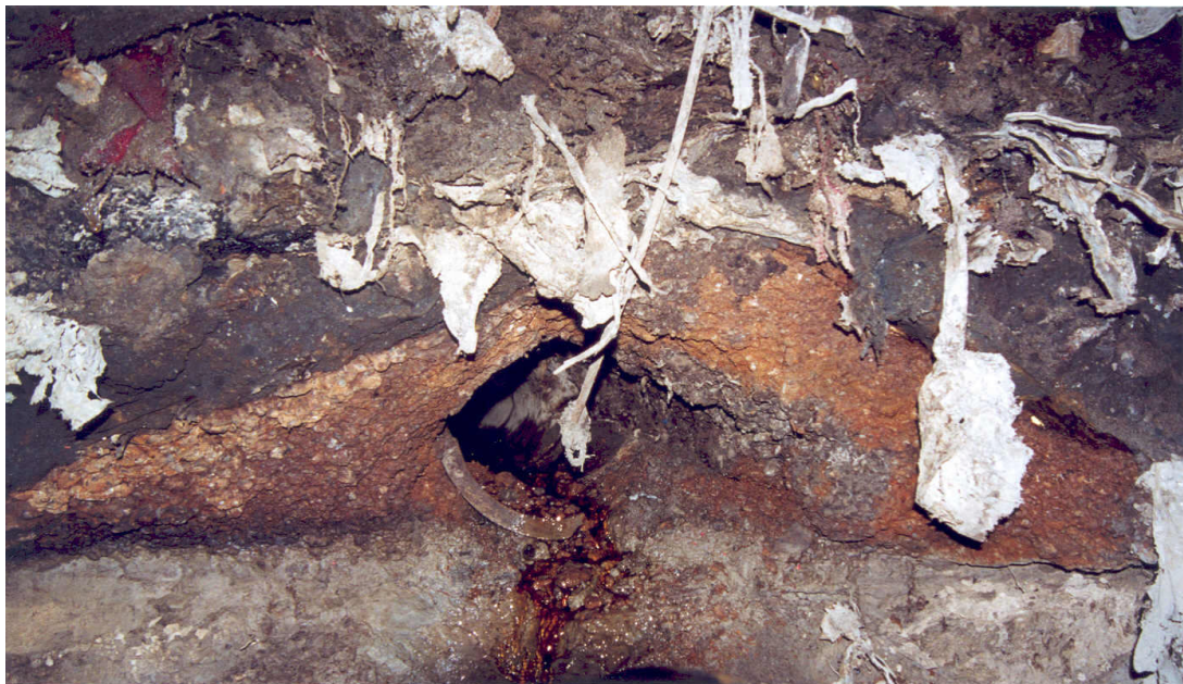
Bild 7 Deponie Am Lemberg - Stark verfestigte Leitungszone in Lemberg
