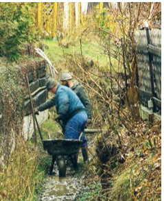
▲ Abfluss erhalten: Räumen und Freischneiden.
