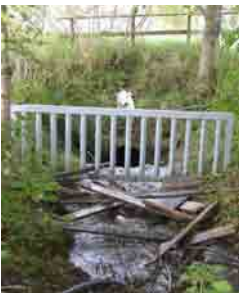
▲ Verrohrungsstrecken vor Verklauung schützen.
