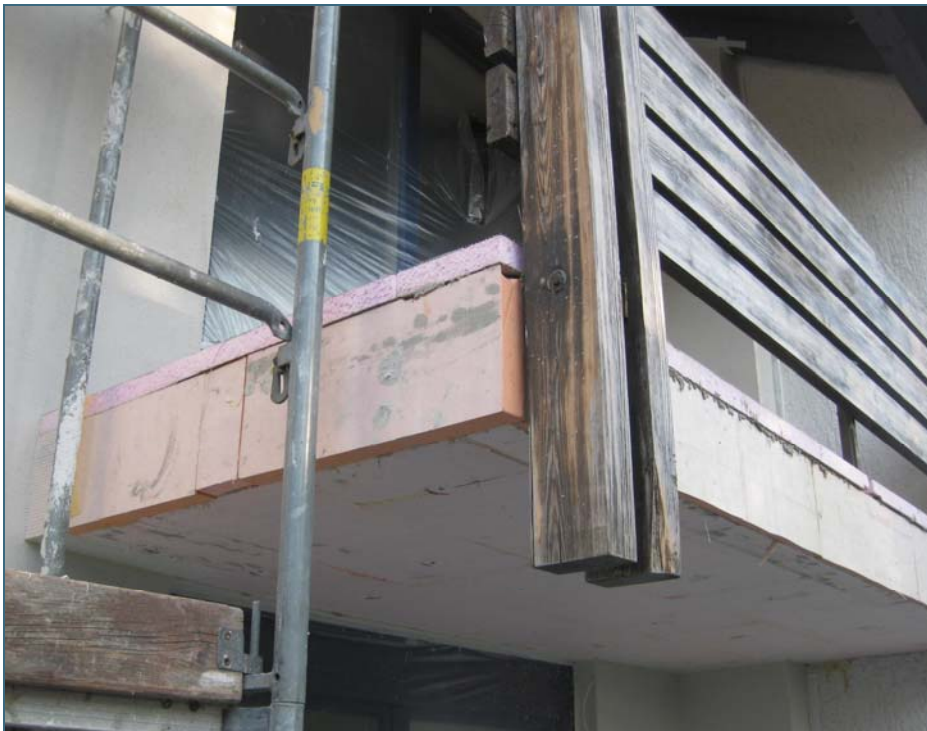
Abb. 19: Durchgehende Balkone aus Beton sind gerade nach einer Fassaden- dämmung gefährliche Wärmebrücken. Sie sollten nach Möglich- keit abgeschnitten und gegebenenfalls durch eine frei ste- hende Konstruktion ersetzt werden. Ist dies nicht möglich, sollte der Beton zumindest mit Dämmstoff eingepackt werden.
