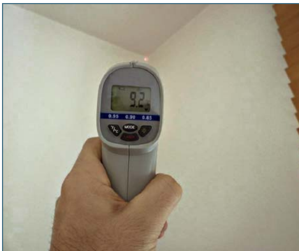
Abb. 3: Messung der Oberflächentemperatur einer Außenmauerecke in einem Gebäude aus ungedämmtem Mauerwerk mit 36-cm-Hochlochziegeln (Baujahr 1999). Bei einer Temperatur von 9,2 °C kann sich schon bei weniger als 40 % relativer Luftfeuchte und 23 °C Lufttemperatur Tauwasser abscheiden und Schimmel bilden.
