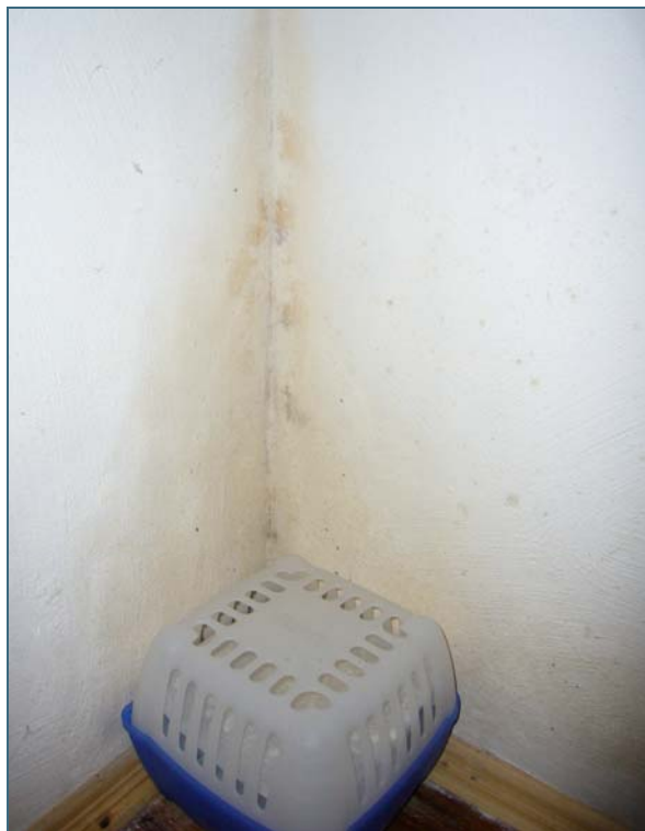
Abb. 18: Vergeblicher Versuch eines Wohnungsbesitzers, die feuchte und schimmelige Außenecke mit einem Entfeuchtungsgranulat (z. B. CaCl 2 ) zu trocknen. Außenecken sind bei alten und ungedämmten Gebäuden geometrische Wärmebrücken, die nach außen viel mehr Wärme abgeben, als sie innen aufnehmen können. Sie kühlen dadurch stark aus und nehmen Kondenswasser aus der Luft auf.
