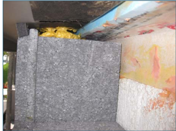
Abb. 21: Besonders wichtig ist gerade im Sanierungsfall das wärmebrückenfreie Ausschäumen der Hohlräume zwischen Fensterblech und Mauerwerk (hier unvollständig ausgeführt).
