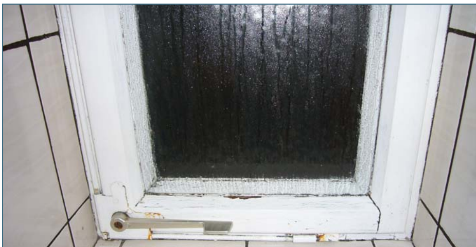
Abb. 14: Kondenswasser an einem alten Badfenster mit Schimmel in den Fliesenfugen und Feuchteschäden an Holz und Metallbeschlägen.
