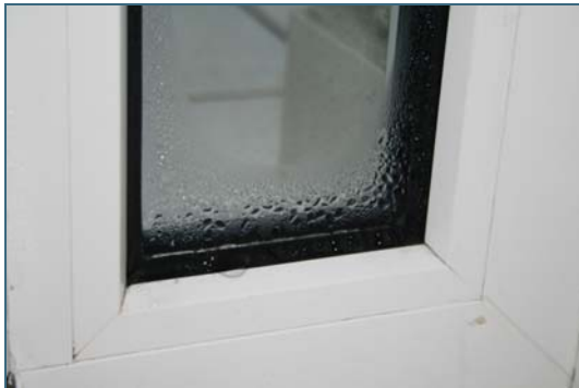
Abb. 3: Tauwasserbildung auf der kalten Fensterscheibe
