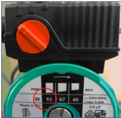
Abb. 1: An der abgebildeten Heizungsumwälzpumpe können drei Leistungsstufen eingestellt werden (roter Schalter). Eingestellt ist die Stufe 3, bei der die Leistungsaufnahme laut Typenschild 93 Watt beträgt.
