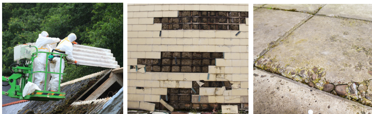
Abb. 14: Beschädigte Dachplatten sollten bald ausgetauscht werden, ebenso kaputte Fassadenschindeln und defekte Bodenplatten.
